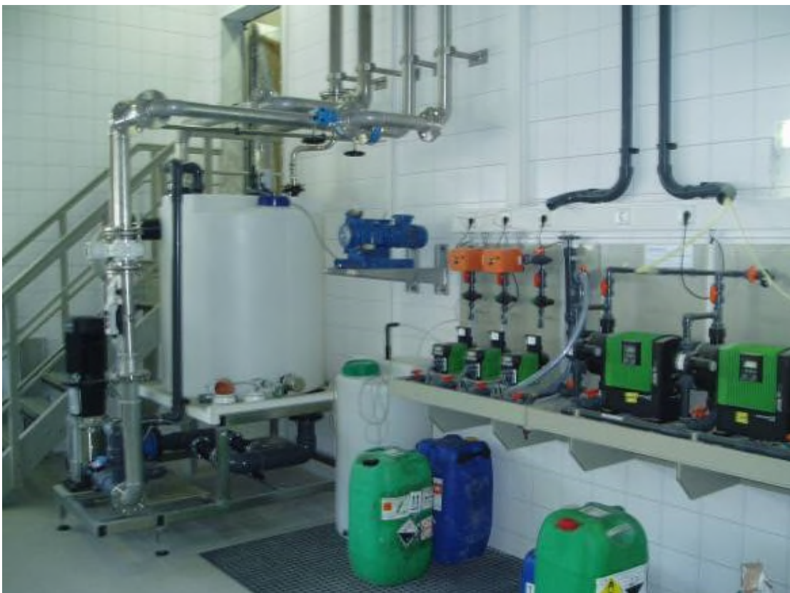
Abbildung 7 CIP-Station und Dosierung Antiscalant
