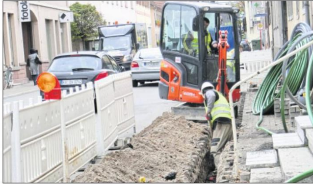
AN DER KARLSRUHER STRASSE werden Gehwege aufgegraben, Leerrohre verlegt und Hausanschlüsse hergestellt. Foto: Gamer
