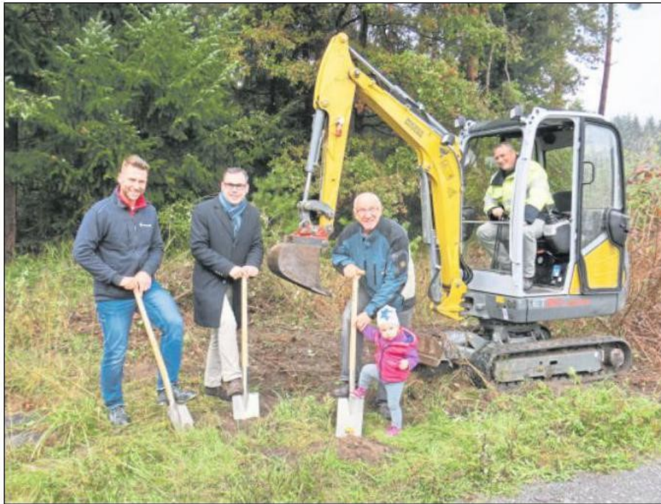
ERDARBEITEN: Markus Feil, Bürgermeister Christian Eheim, Gemeinderat Wolfgang Bauer und Christian Warzel (von links) beim Spatenstich. Foto: Gamer
