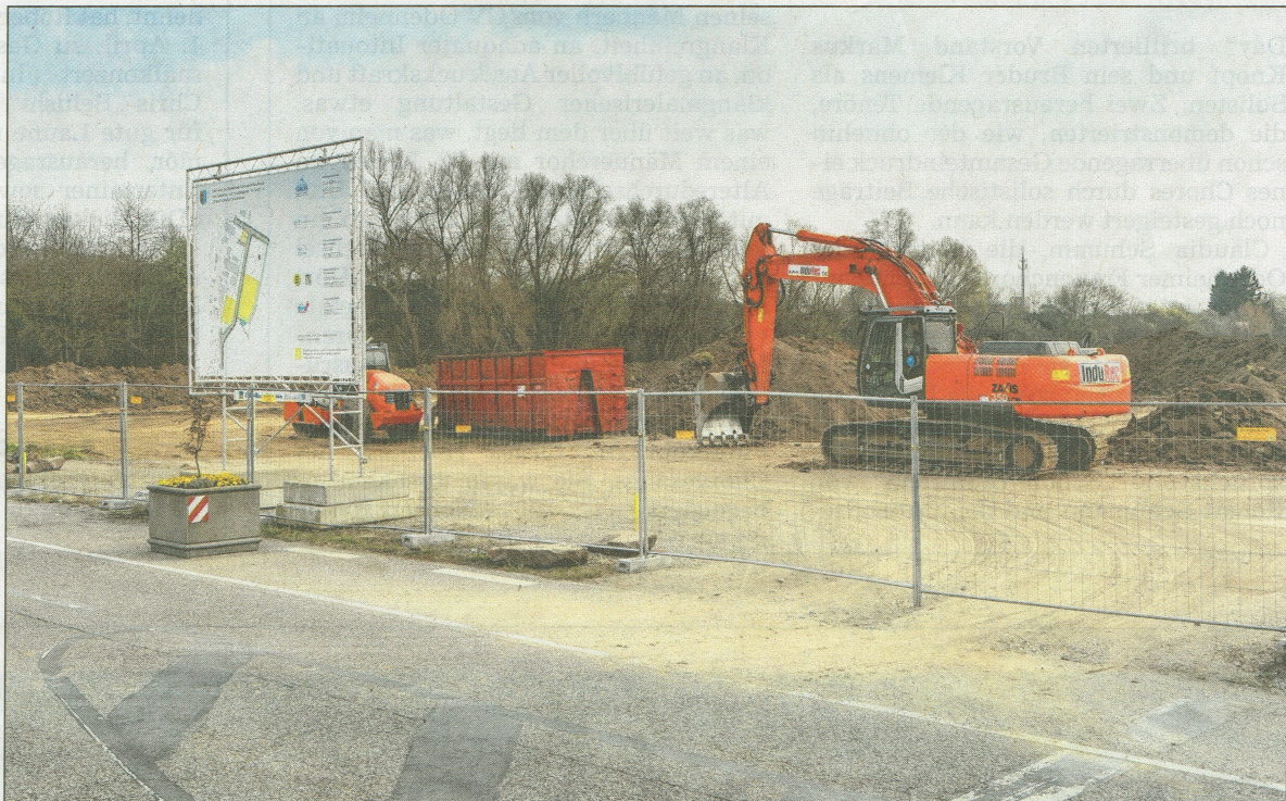
GROSSE ERDBEWEGUNGEN sind unmittelbar an der Autobahn in Karlsdorf im Gange. Dort entstehen ein Aldi- und ein dm-Markt. Foto: Heintzen
